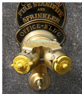
Boca de riego contra incendios. Fachadas de edificios N.York
